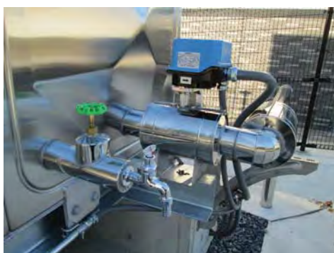
緊急遮断弁と給水栓
