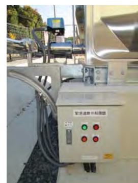
緊急遮断弁用制御盤
